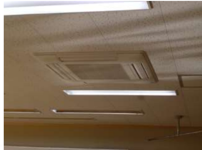
城北中学校のエアコン
